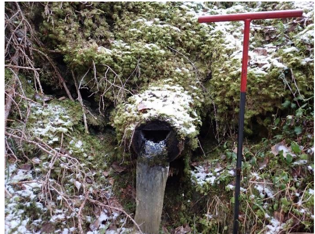
Kuva 55. Tervaputken suu ja sille jäänyt vesinoro. Kuva: Hannu Poutiainen.
